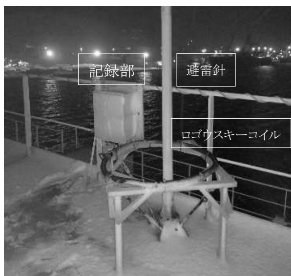
図5 「すいせん」設置状況
