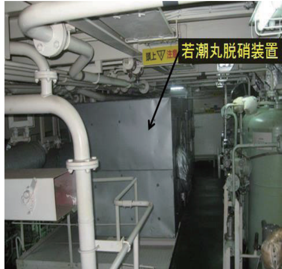
図9 若潮丸脱硝装置
