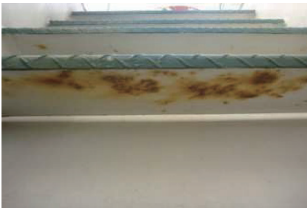
図3 母材から発錆した状態
