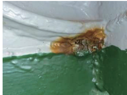
図1 溶接スラグの介在により酸化した箇所
