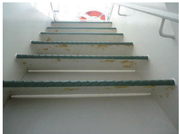
図4 防錆作業後、1年経過し発錆した箇所
